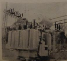
Un trasformatore di una centrale elettrica.
